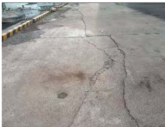
写真 7-1 空洞発生箇所のエプロン
