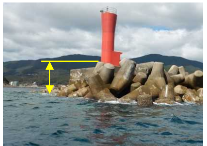
消波ブロック沈下の様子
