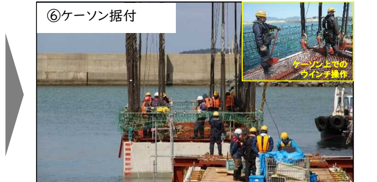
⑥ケーソン据付 ケーソン上で作業員がウインチを操作し、ケーソンを最終据付箇所にセット後、海水を注水して沈めます。
