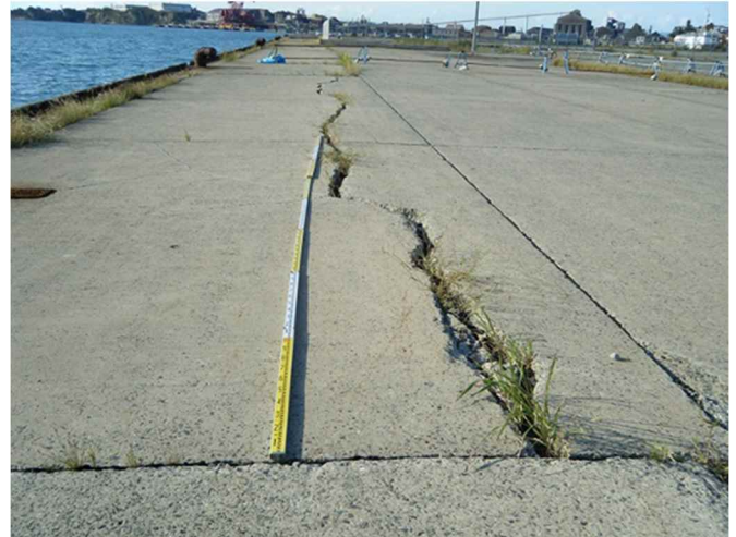
【エプロンのひび割れの状況】
