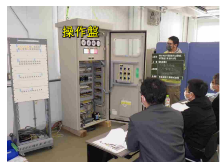
ゲート機側操作盤確認状況
