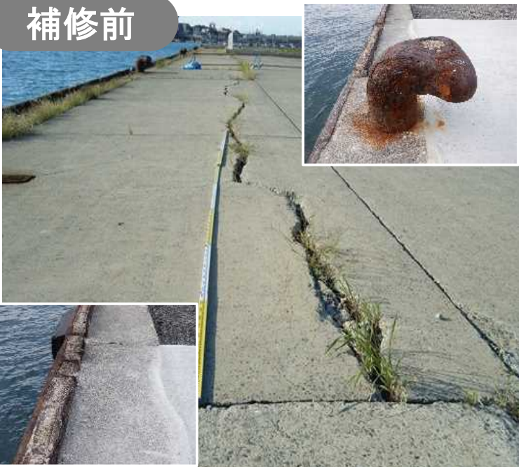
エプロン(ひび割れ、空洞化)
