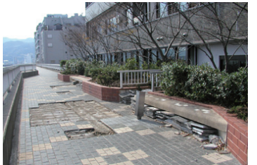
台風23号による北浜旅館街の被害の様子
