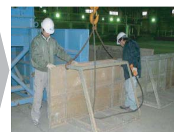
⑦波が領域の外側へ逃げないように鋼製の板（導波板）を設置する
