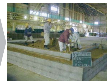
②護岸背後の外周をブロックで固定し、護岸背後の地盤となる中詰土を投入する。
