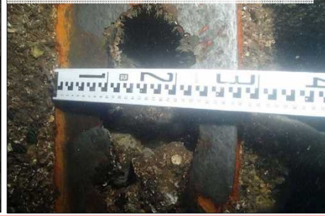
【土留め矢板腐食（穴あき）状況】
