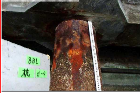
【鋼管杭腐食状況】
