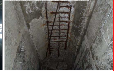
【スラブ下面鉄筋露出状況】
