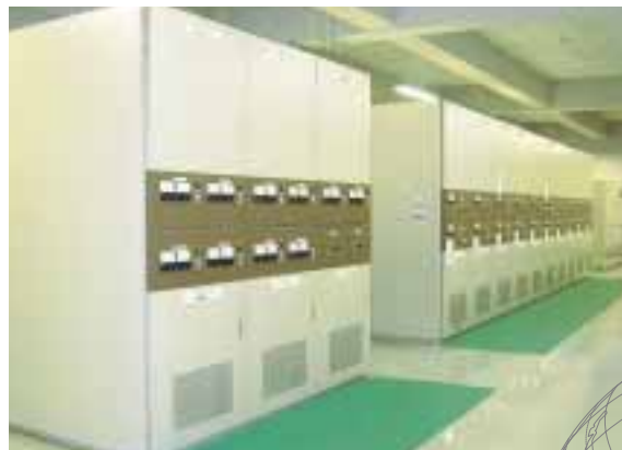
定電流変圧器(CCT) 定電流調整器(CCR)
