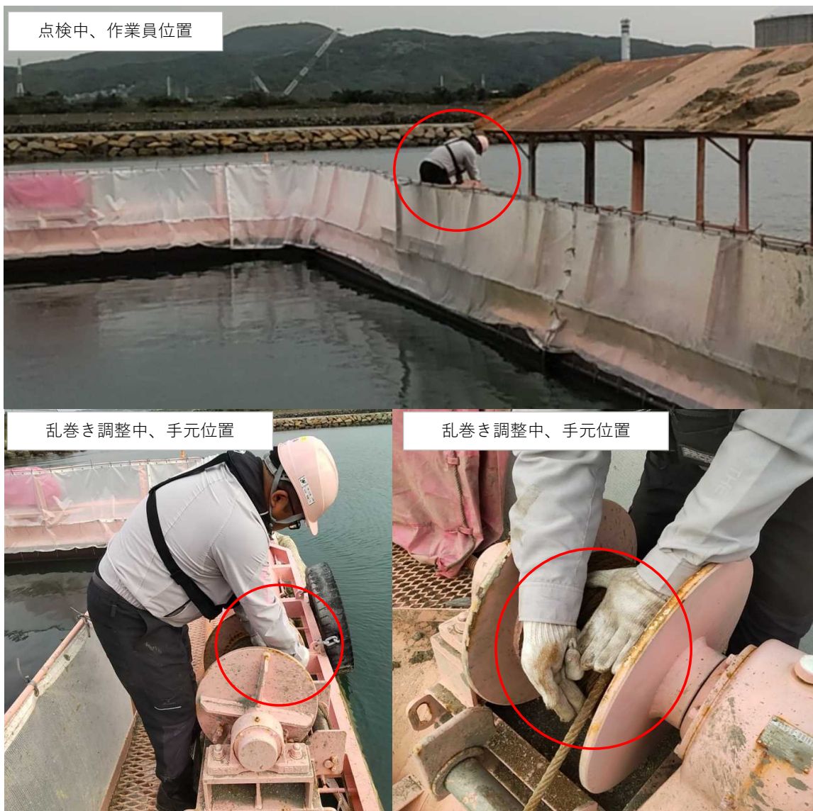
事故発生状況の再現写真
