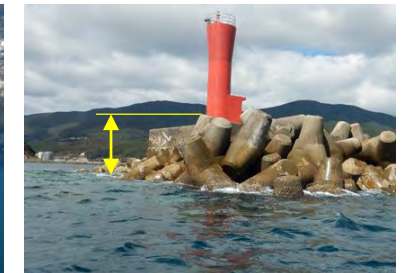
消波ブロック沈下の様子
