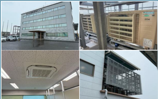
管理棟の省エネルギー（空調設備）
