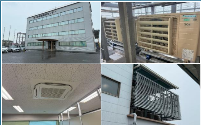
管理棟の省エネルギー（空調設備）
