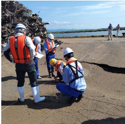
クラック幅計測の状況
