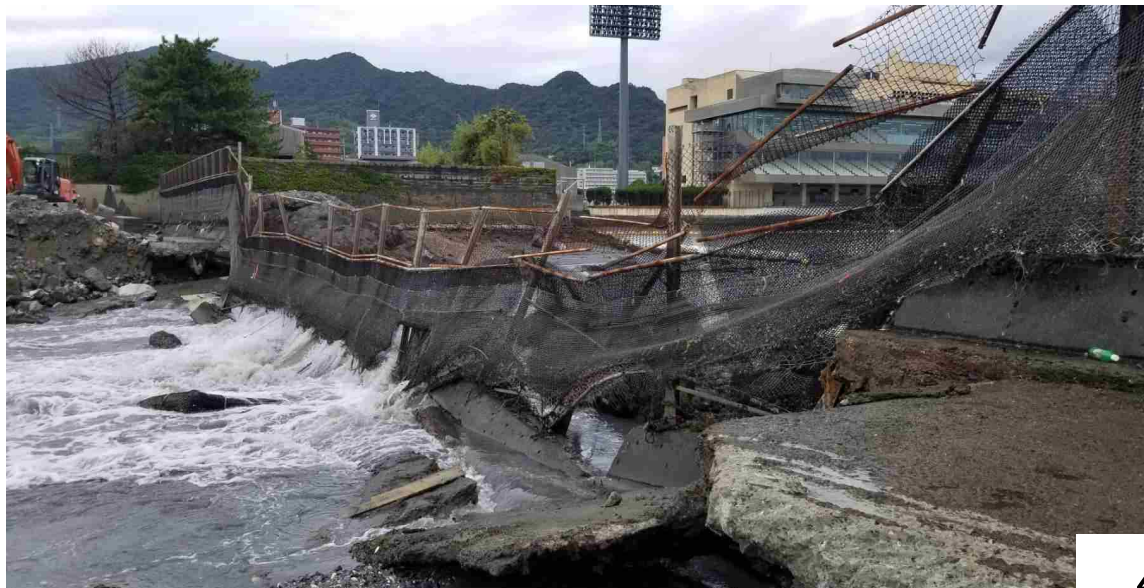
被災後の状況
