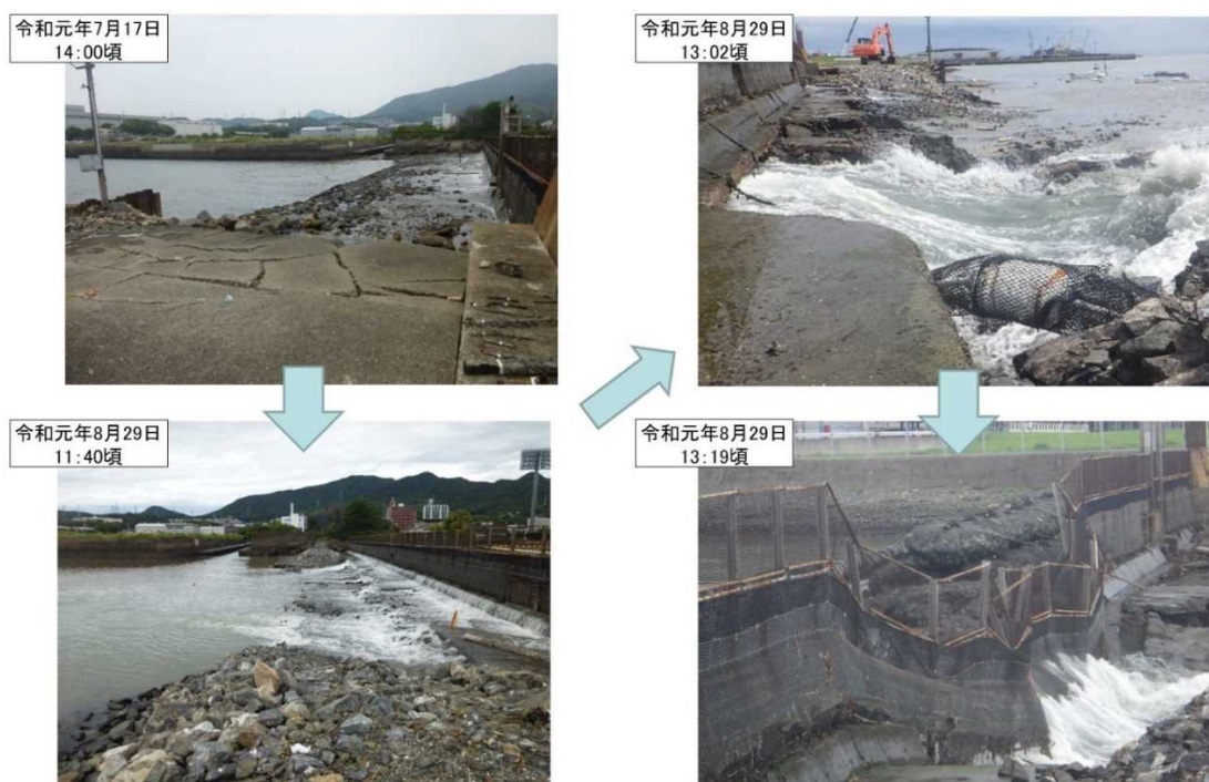
写真２－１－３ 護岸被災の時系列写真
