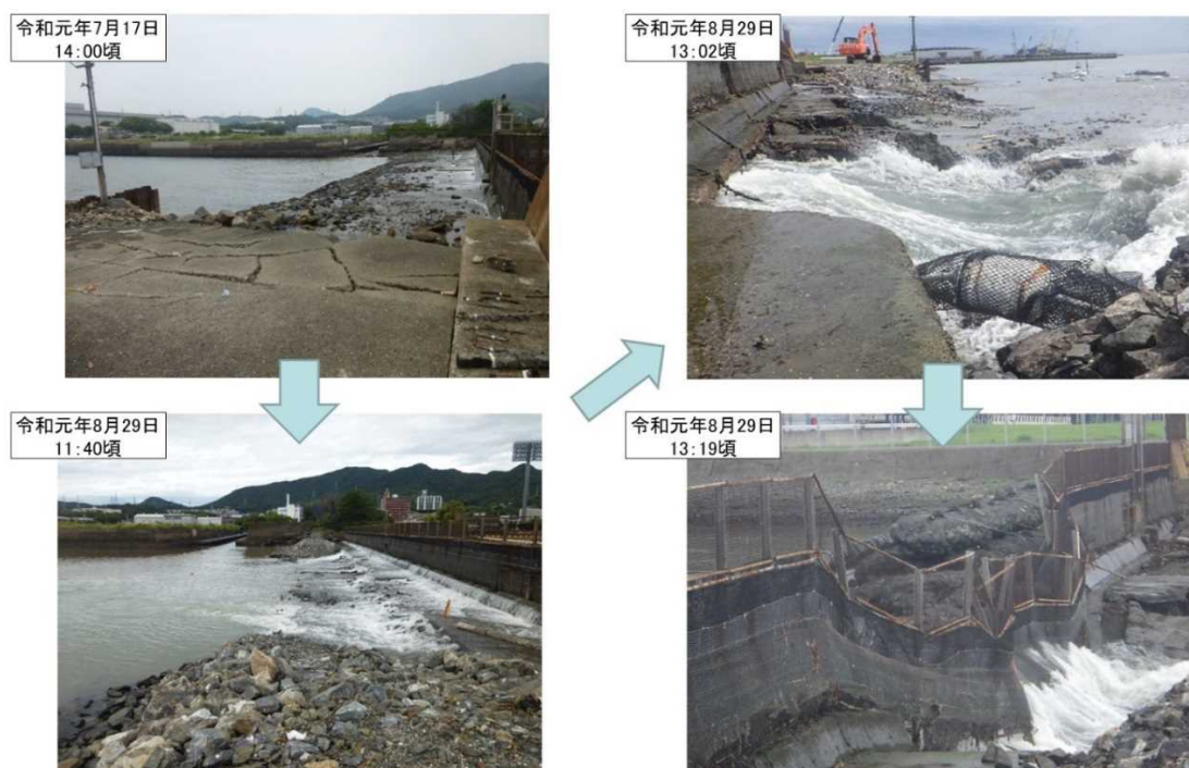
図２－１－３ 護岸被災の時系列写真
